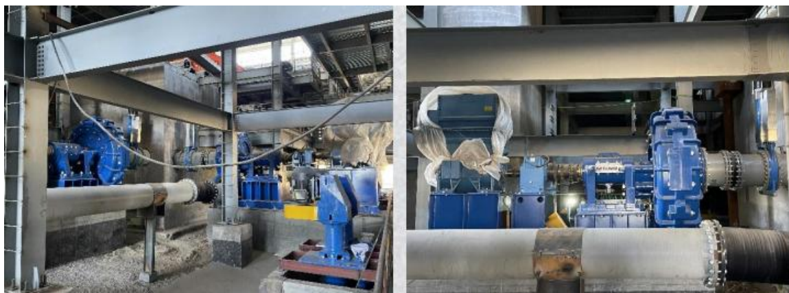
图：额尔登特扩产项目DN600/DN700旋流器上浆管、沉砂管及溢流管
